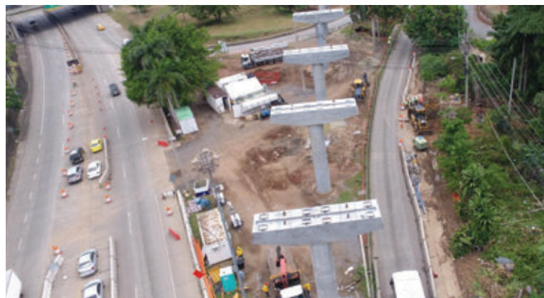
Em agosto, começaram a se instalar as vigas de passagem dos trens.
