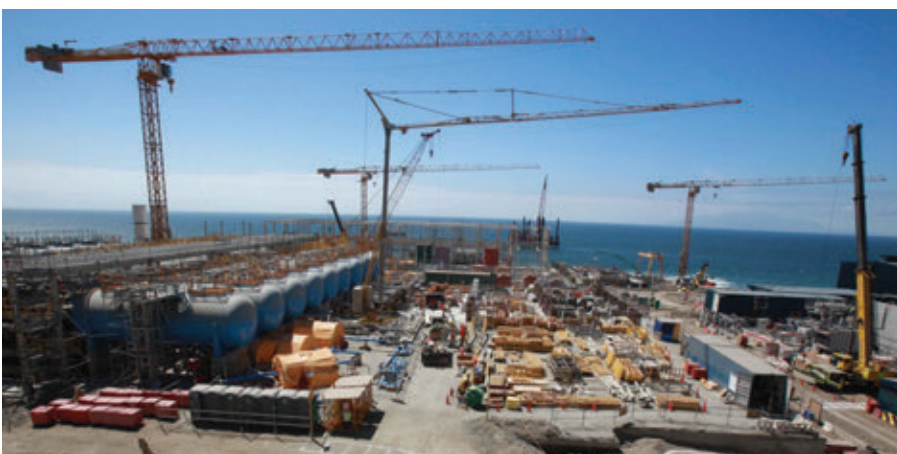
Entre outros contratos recentes, a Sigdo Koppers, maior construtora do Chile, realizou a Planta Dessalinizadora na jazida mineral Escondida.
